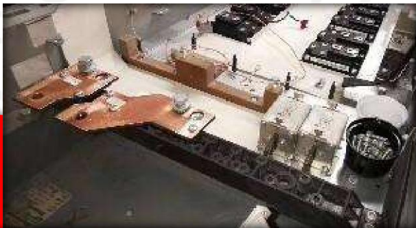
VARIADOR DE FRECUENCIA
